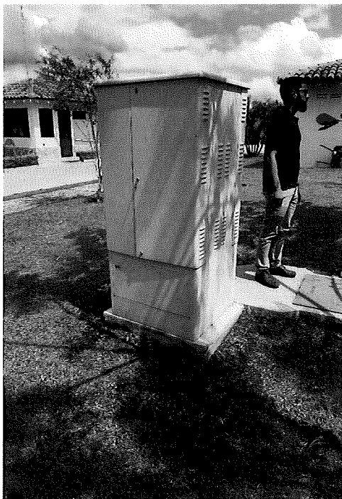
Ilustración 3. Condominio Terrazas del Oeste Etapa III. Armario KÖLBI.
