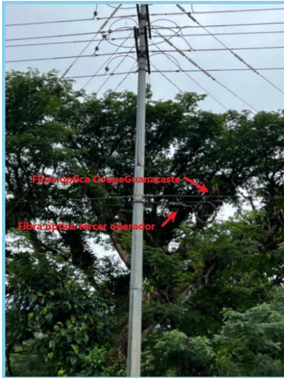
Figura 2. Poste metálico propiedad de COOPEGUANACASTE con soporte de fibra óptica de un tercer operador de telecomunicaciones.
